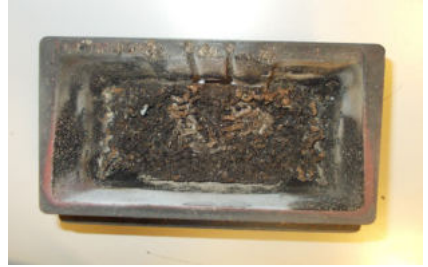
BEISPIEL VERSCHMUTZTE BRENNSCHALE
