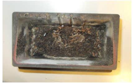
BEISPIEL VERSCHMUTZTE BRENNSCHALE
