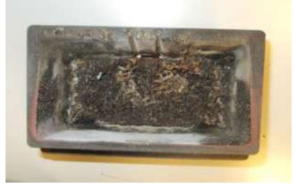
BEISPIEL VERSCHMUTZTE BRENNSCHALE
